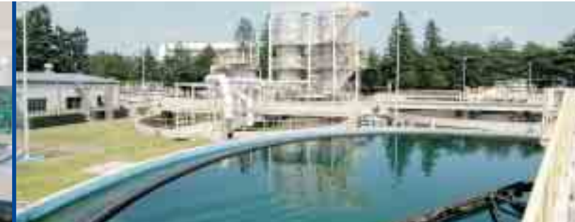
排水処理施設
