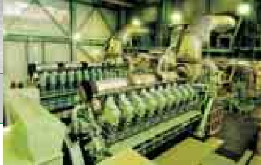
コ・ジェネレーションシステム
