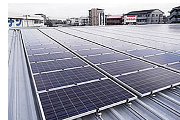
神奈川日産自動車(株)の一部の販売店の屋根に設置した太陽光パネル。得られた電力を日産がPPSとして調達し販売店に供給しています
