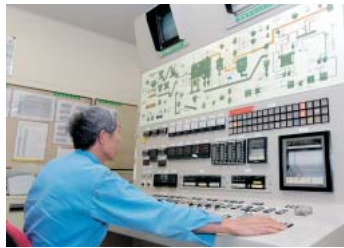
再資源化施設の オペレーションルーム (追浜工場)
