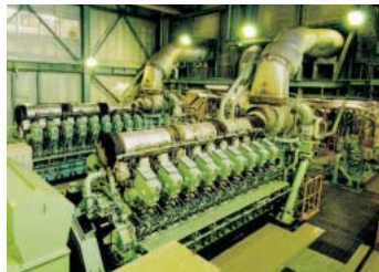
コ・ジェネレーションシステム(栃木工場)
