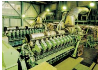
コ・ジェネレーションシステム(栃木工場)
