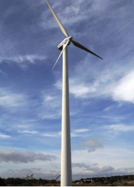
自然エネルギーを有効利用するために導入された風力発電設備（英国）
