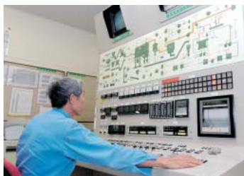
再資源化施設の オペレーションルーム (追浜工場)
