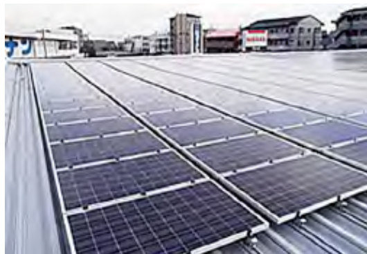
神奈川県日産自動車(株)の一部の販売店の屋根に設置した太陽光パネル。得られた電力を日産がPPSとして調達し販売店に供給しています
