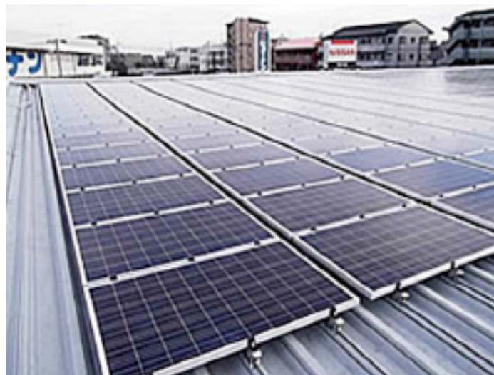
神奈川日産自動車（株）の一部の販売店の屋根に設置した太陽光パネル。得られた電力を日産PPSとして調達し販売店に供給しています
