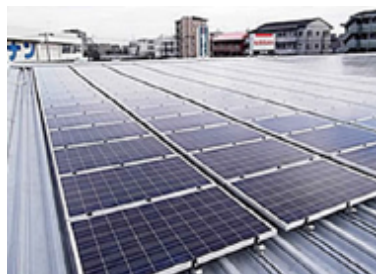
神奈川日産自動車（株）の一部の販売店の屋根に設置した太陽光パネル。得られた電力を日産PPSとして調達し販売店に供給しています
