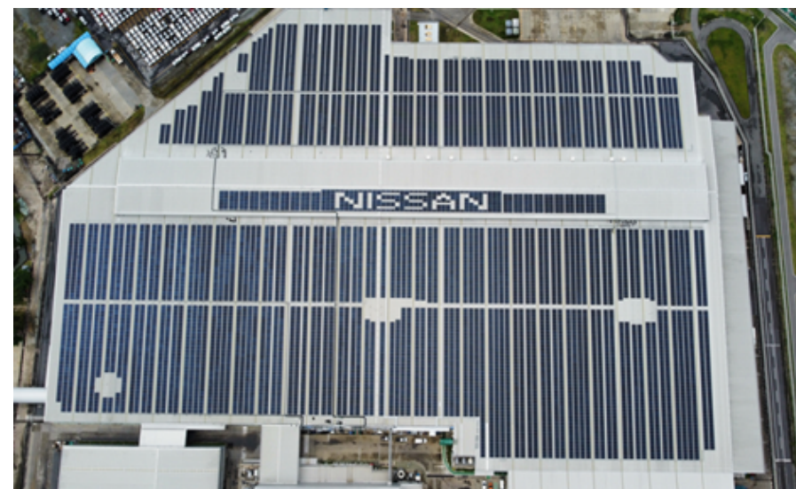
タイ工場の5.5MWの太陽光発電
