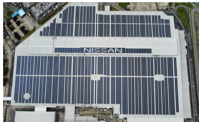
タイ工場の5.5MWの太陽光発電
