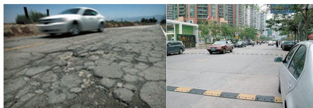
図-14 ひび割れた路面、スピードバンプ Fig. 14 Broken asphalt and speed bump
