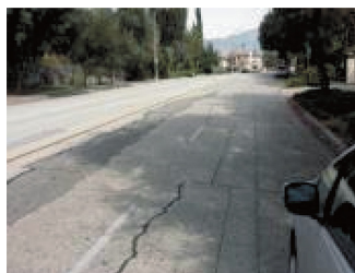
図-5 ひび割れが生じた道路 Fig. 5 Cracked road
